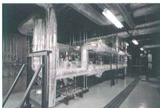
地域暖房設備
