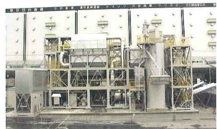
コンクリート再生用プラント
