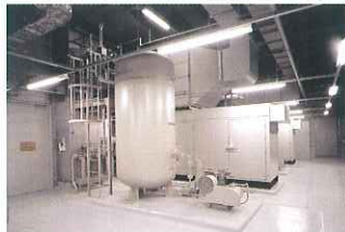
コージェネレーション設備
